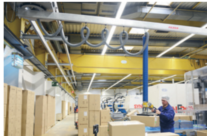
HBS-ZSK-100KG-22000-SK-4000 Zweischienenkran mit Drehkranz für großräumige Flächenausnutzung
